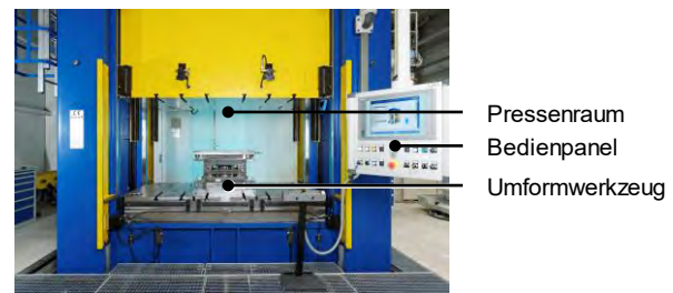
Abbildung 4: Presse und Pressenraum für die Fließpressversuche
